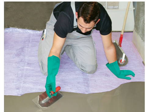
Die geeignete PCI Bodenausgleichsmasse wird auf der ausgelegten Glasfaserverstärkung PCI Armiermatte GFM ausgegossen und mit einer Spachtel verteilt (Mindestschichtdicke 5 mm).
