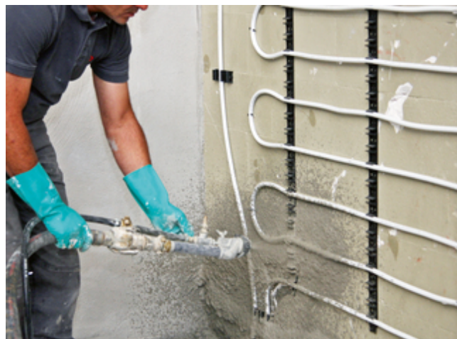
10. Sopro RAP 2® kann auch maschinell im Spritzverfahren aufgebracht werden – wie hier zur Einbettung einer Wandheizung (Kermi x-net c21).
