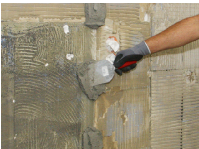
5. Zum späteren Abziehen des Mörtels werden Putzschienen gesetzt. Hierzu zunächst den Putz in Batzen aufbringen ...
